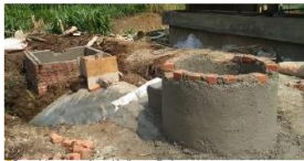
Tempak bangunan sistem biogas terdome
