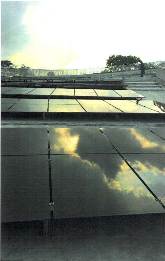
Gambar 4.28: Solar Cell di atap Gedung IFC
