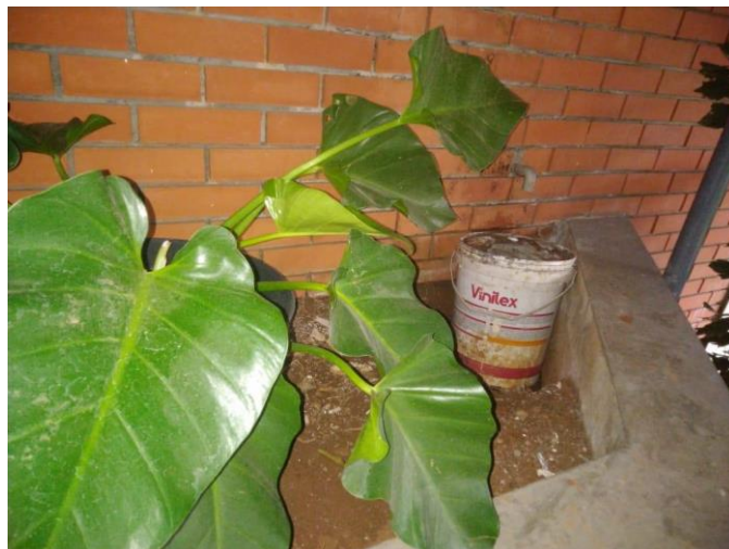
Penampungan Air Kondensasi AC
