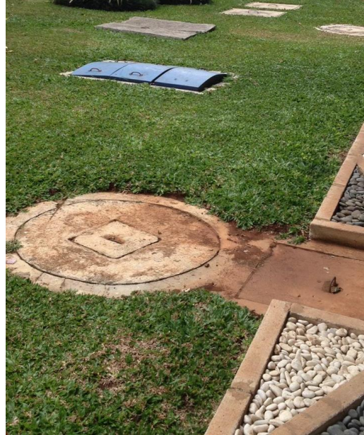
Sumur Resapan di Gedung Pascasarjana
