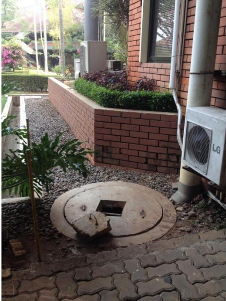
Sumur Resapan di Gedung Dekanat
